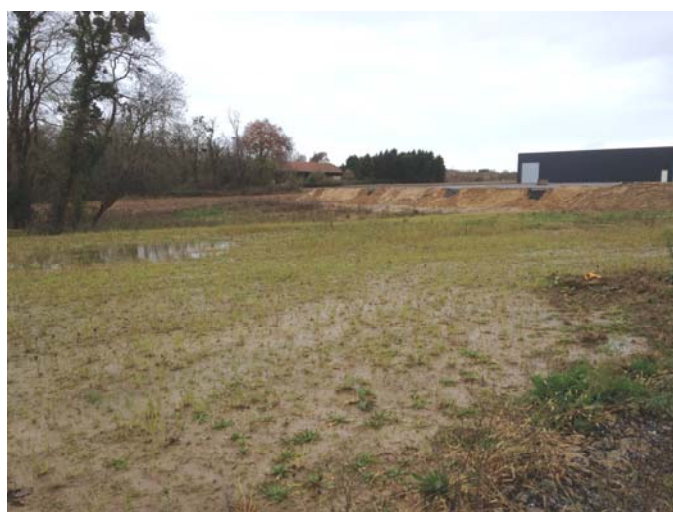
Terrassements importants dans la zone d'activité du Seignanx. C'est pourtant la zone la plus plane parmi le zonage AUéo!
